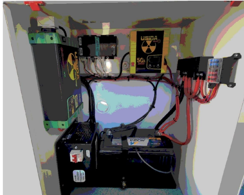
IMAGEM CENTRAL ELÉTRICA FINALIZADA
