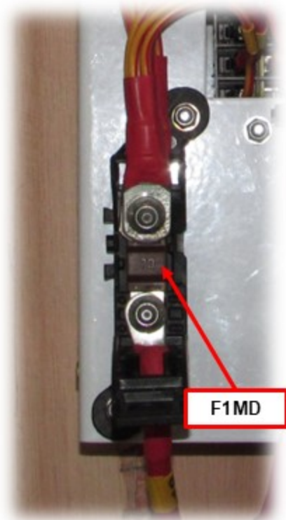
FUSÍVEL DE PROTEÇÃO ATRÁS DO QUADRO - QUARTO
